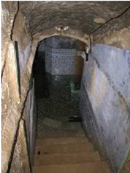
Aljibe o depósito donde se recoge el agua del pozo (CEIP San Francisco de Cájar, junio 2018)
