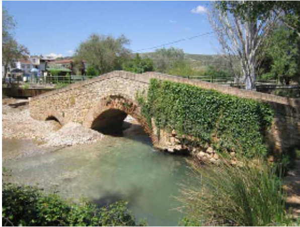
Puente del río Salado junto a la Plaza de San Isidro (Ayuntamiento de Loja, marzo 2015)
