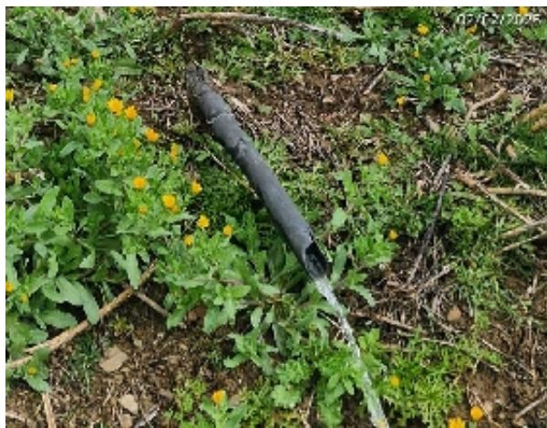
Detalle del caño de polietileno echando un chorrillo de agua (A. Ventas, febrero 2025)
